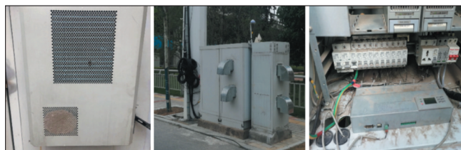
图2 户外一体化机柜运行场景案例
